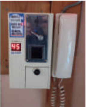
硬貨を投入すると給湯が始まり、利用後は各自で湯を抜くという運用。内湯50分1000円という手頃な料金は豊富な湯量によるところも大きいですが、セルフサービスの気軽さが利用シーンを広げているともいえる
